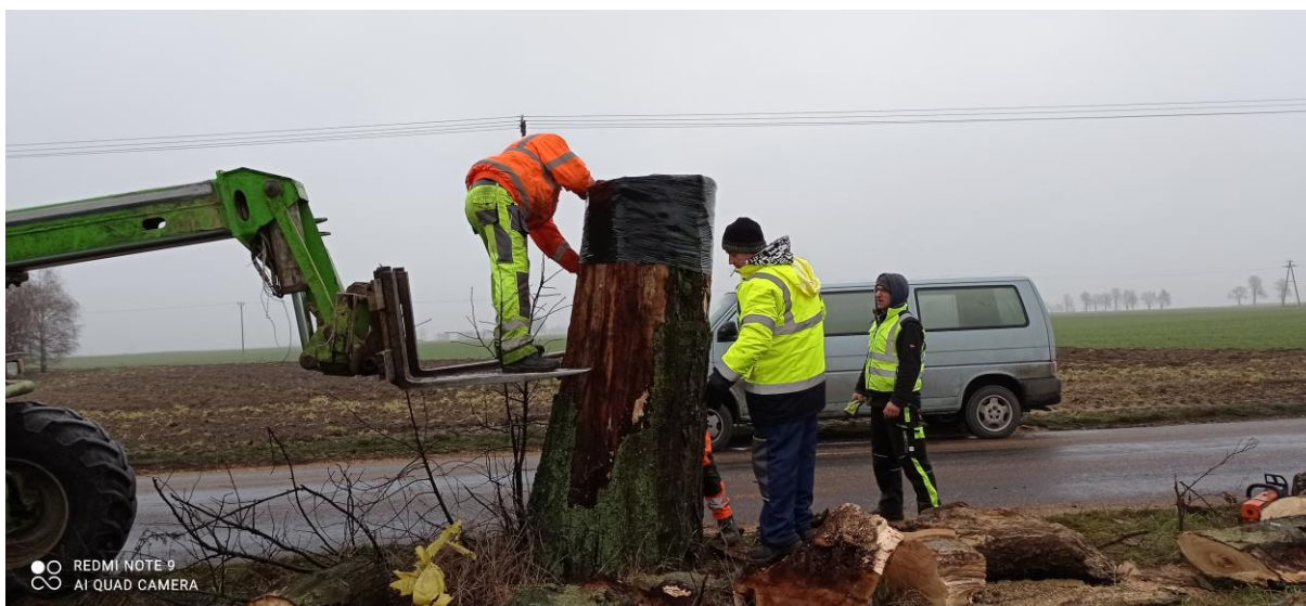
Fot. 1 Zabezpieczenie fragmentu drzewa zasiedlonego przez gatunki chronione – droga powiatowa nr 1049C
